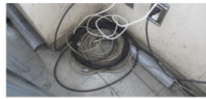
電源周りの清掃が不十分
