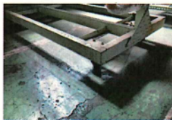
刀掛け台車にストッパー未設置
